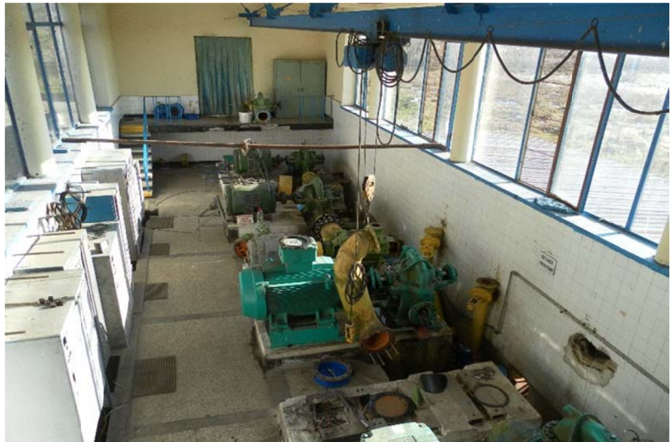
Effizienzsteigerung in Pumpstationen
