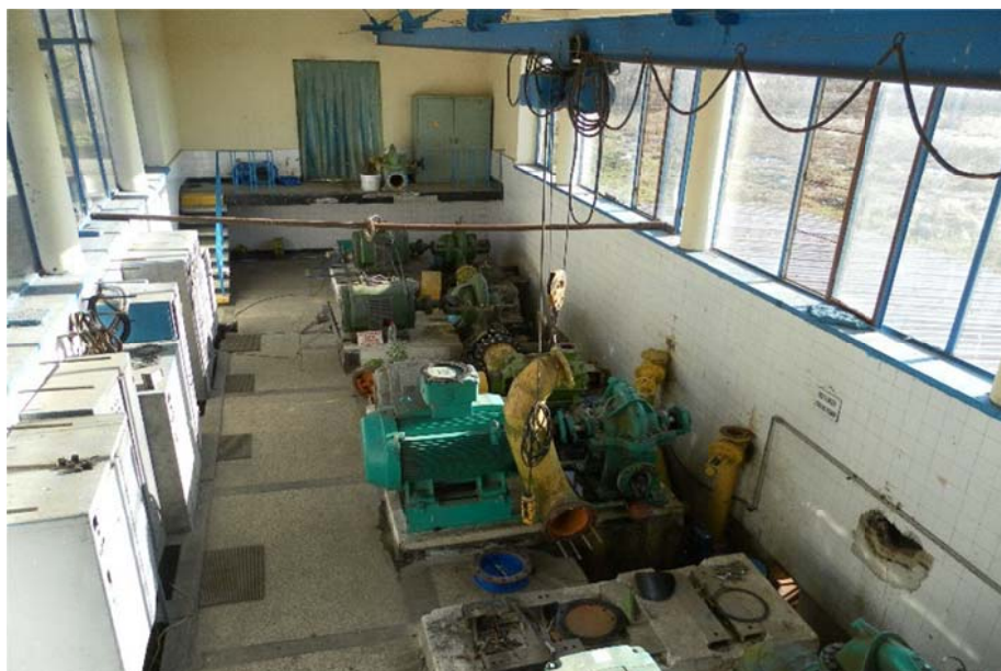
Augmentation de l'Efficacité au sein des Stations de Pompage
